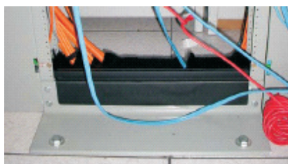
KoldLok auf dem Doppelboden
