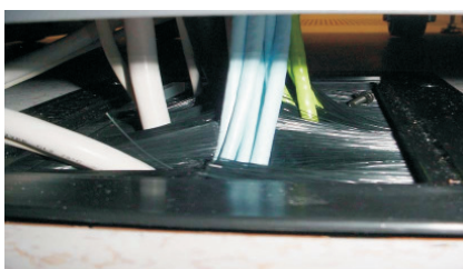
KoldLok im Doppelboden
